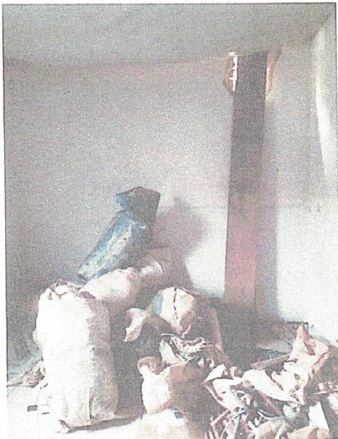
Foto 04: parede atingida do quarto
